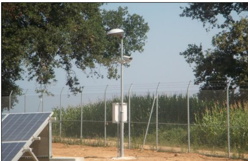
Figura 10 – Tipico palo di sostegno per illuminazione e videosorveglianza
