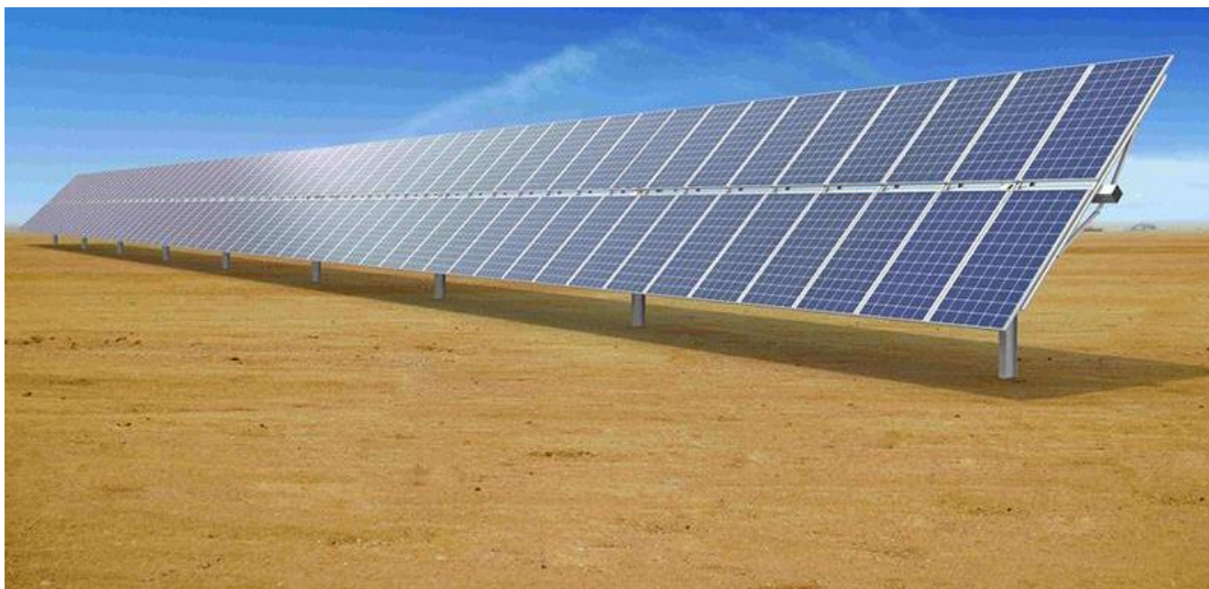
Figura 8 – Strutture di sostegno dei moduli "tracker"
