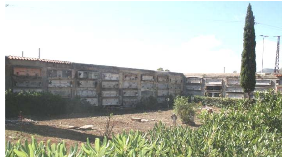
Vista dall'intervento. Angolo sud ovest. I loculi nello spessore del muro di cinta
