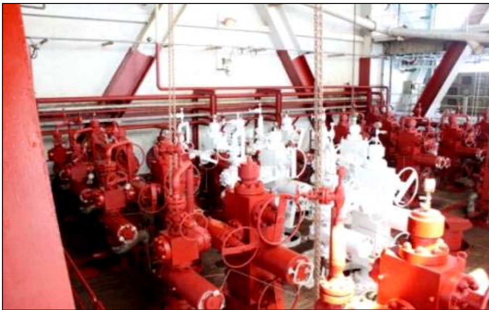
Figura 3.f: Piattaforma Vega A - Teste Pozzo
