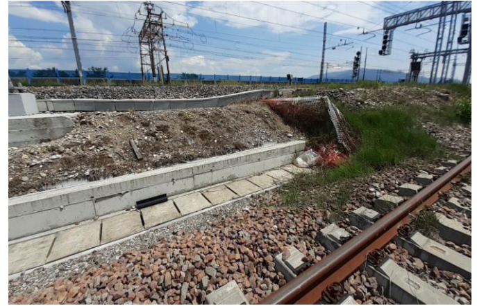
Figura 80 Foto4 canaletta di drenaggio a servizio della linea AV Milano Venezia
