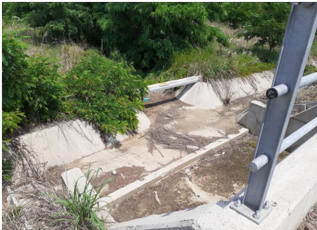
Figura 107 Foto 3 Scarico delle canalette di drenaggio dei fabbricati nel tombino IN03
