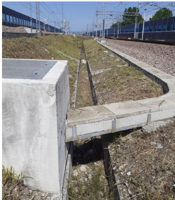
Figura 65 Fotografia 5 – Canaletta di raccolta acque meteoriche
