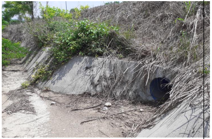
Figura 108 Foto 4 sbocco di una tubazione nella canalina di drenaggio che scarica in IN03
