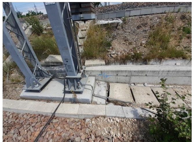
Figura 78 Foto 2 Canaletta di drenaggi a servizio della linea AV Milano - Venezia
