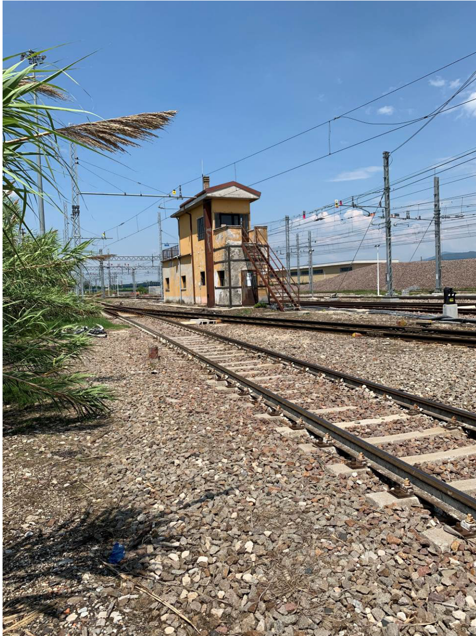
Foto n.7 - Cabina elettrica esistente
