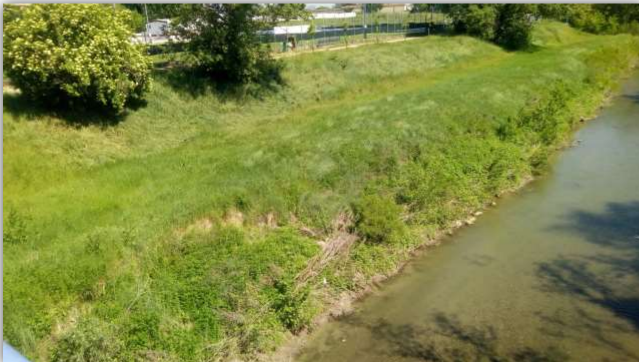
Figura 2-17: Tratto della sponda sx del torrente Idice prospiciente il campo sportivo di Castenaso: si riscontra presenza di fenomeni erosivi di entità lieve e presenza della specie invasiva Amorpha fruticosa .
