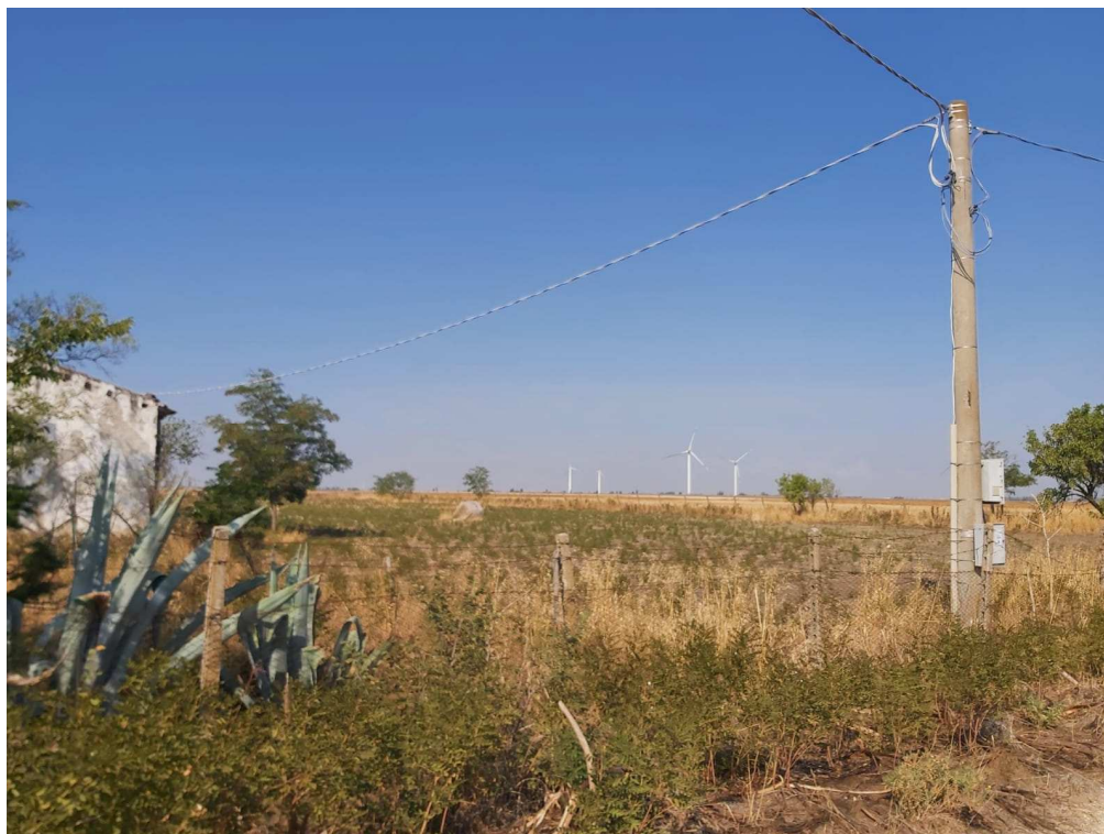
Linea di alimentazione elettrica per presa d'acqua pozzo artesiano
