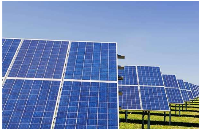
Figura 21: Impianto fotovoltaico con moduli di tipo policristallino 2/2
