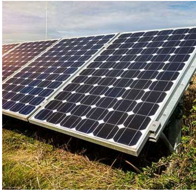
Figura 20: Impianto fotovoltaico con moduli di tipo monocristallino 1/2
