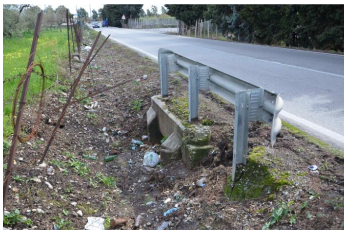
Stato Attuale S.P. 16 – Opere idrauliche fatiscenti: tombini, fossi, pozzetti di caduta
