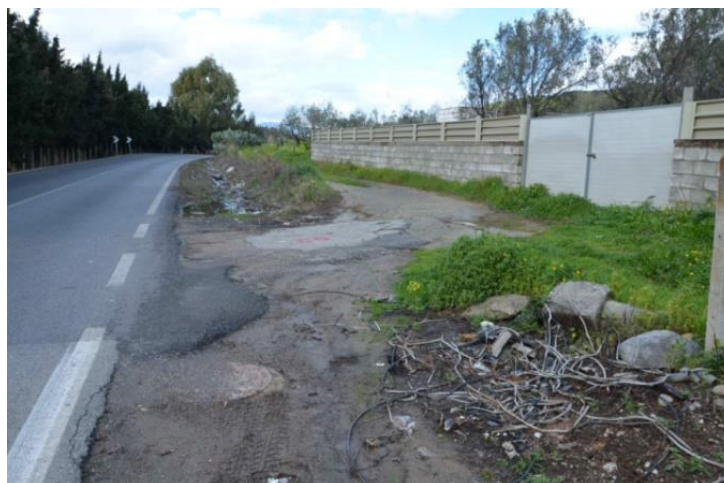
Stato Attuale S.P. 16 – Accessi e usura del pacchetto stradale
