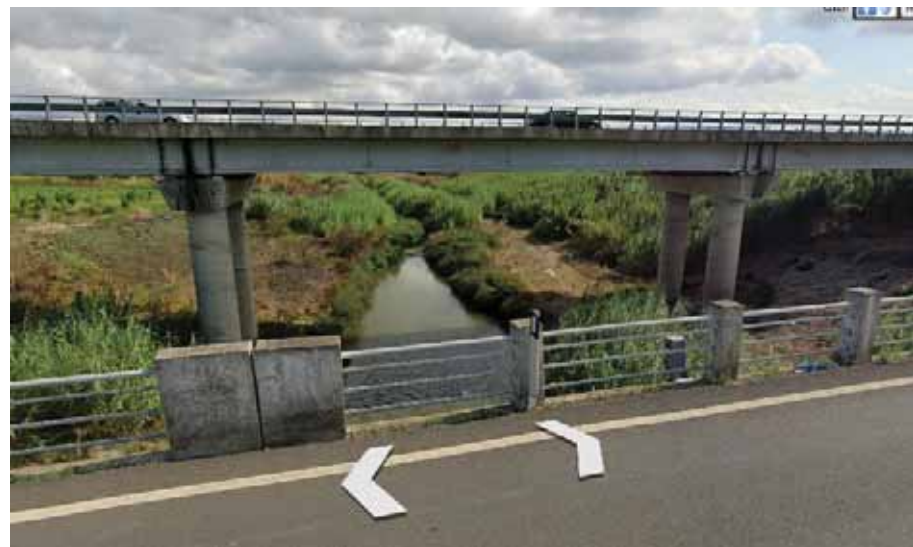
Figura 5-32. Vista del viadotto esistente della SS 114 sul fiume San Leonardo, ripreso dalla SS 194 (fonte Google Earth)
