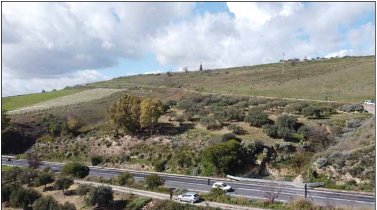
Foto 6-18 panoramica colamento L3_4
