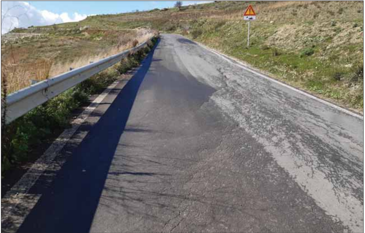
Foto 6-21 danni su SP38 dovuti alle attivazioni del fenomeno gravitativo
