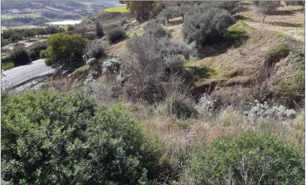
Foto 6-19 incisione torrentizia corrispondente al fianco sinistro del dissesto gravitativo
