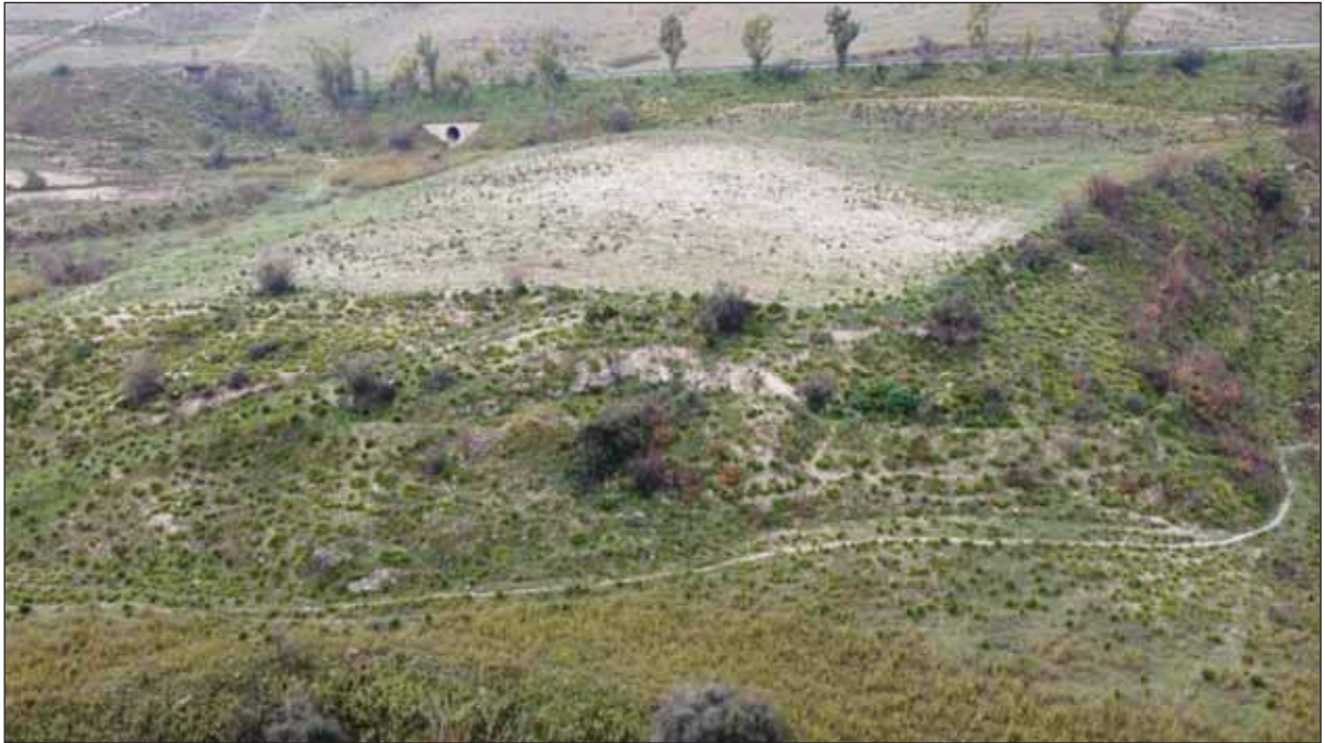
Foto 6-1 panoramica del dissesto da Est
