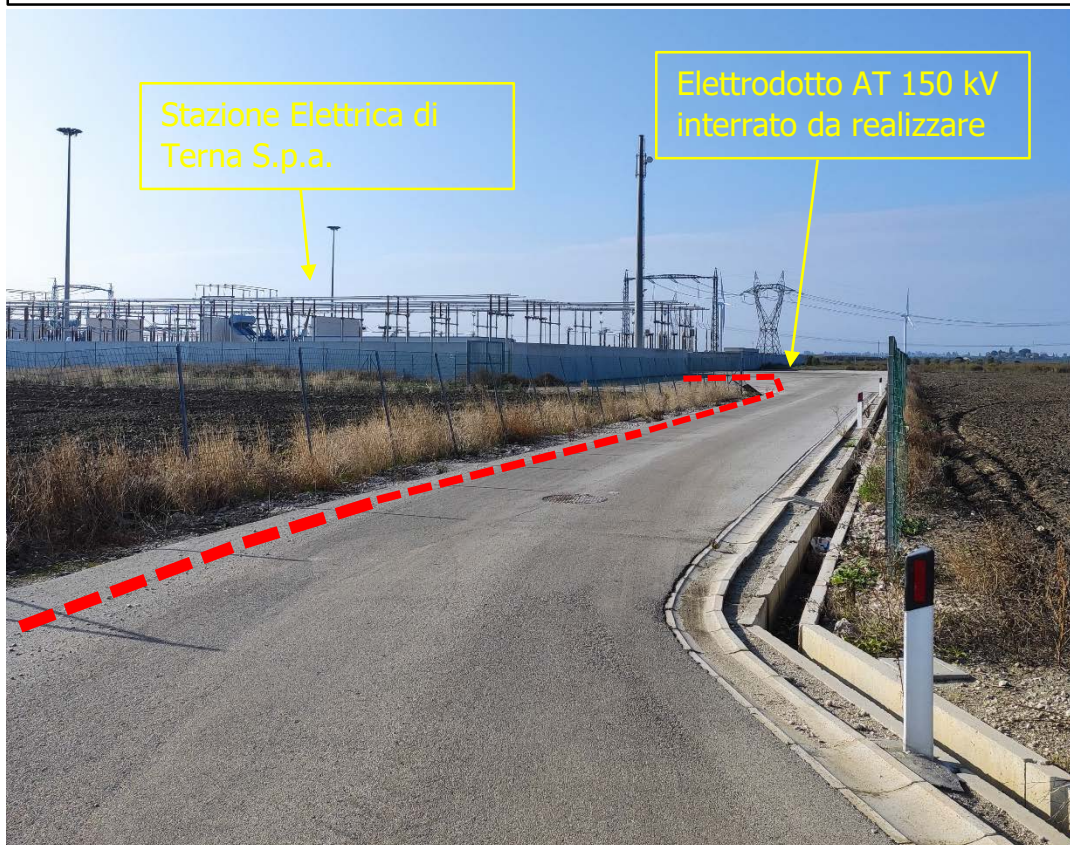
Foto n°11: Elettrodotto AT su strada privata e punto di consegna Stazione Elettrica di Terna S.p.a.
