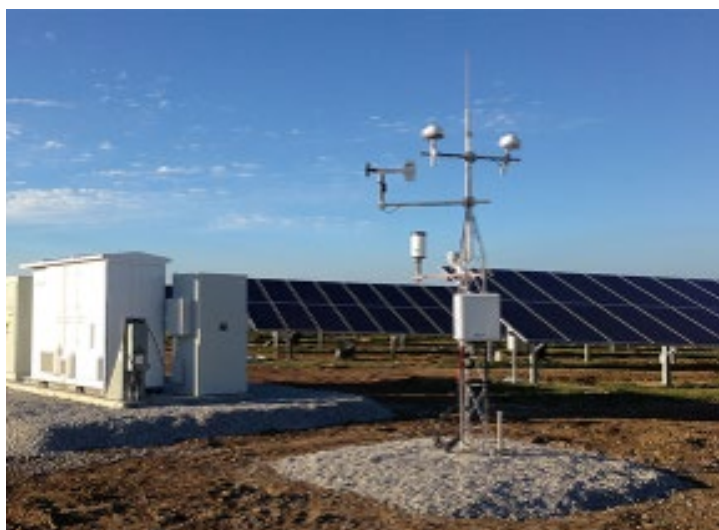
Figura 4-Esempio di stazione meteorologica
