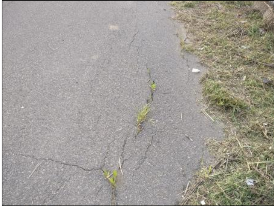
Foto 7.4 – Vistose lesioni e deformazioni presenti sulla strada di Svincolo citata coincidenti con il coronamento della Frana L4_1.
