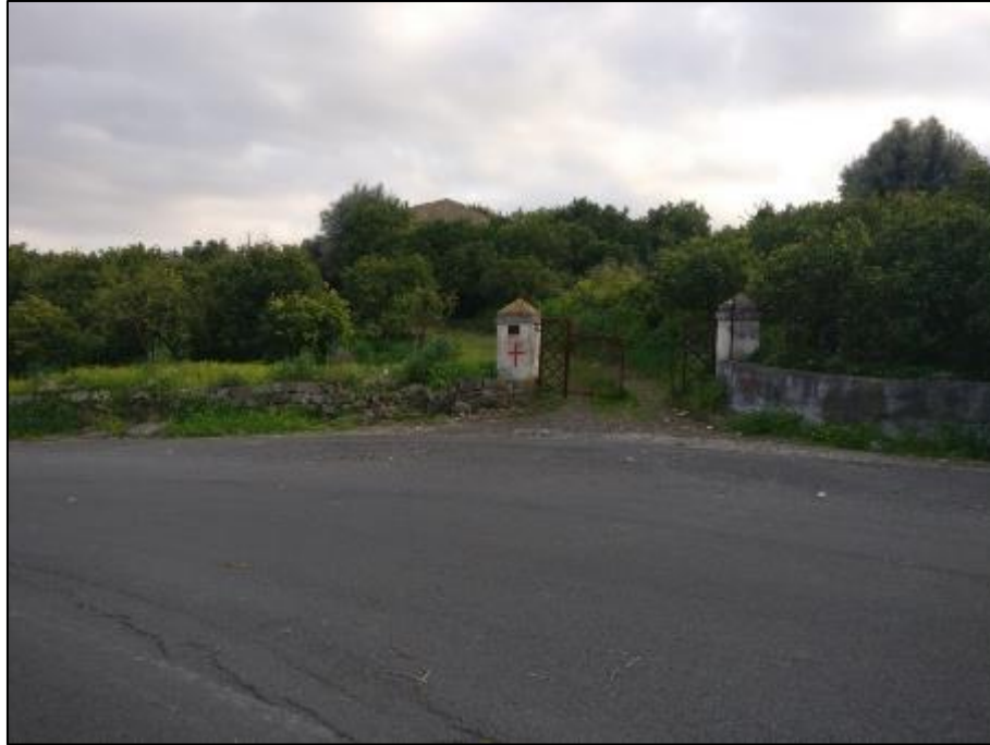
Foto 7.6 – Vistose lesioni e deformazioni presenti sulla strada di Svincolo citata coincidenti con il coronamento della Frana L4_1.
