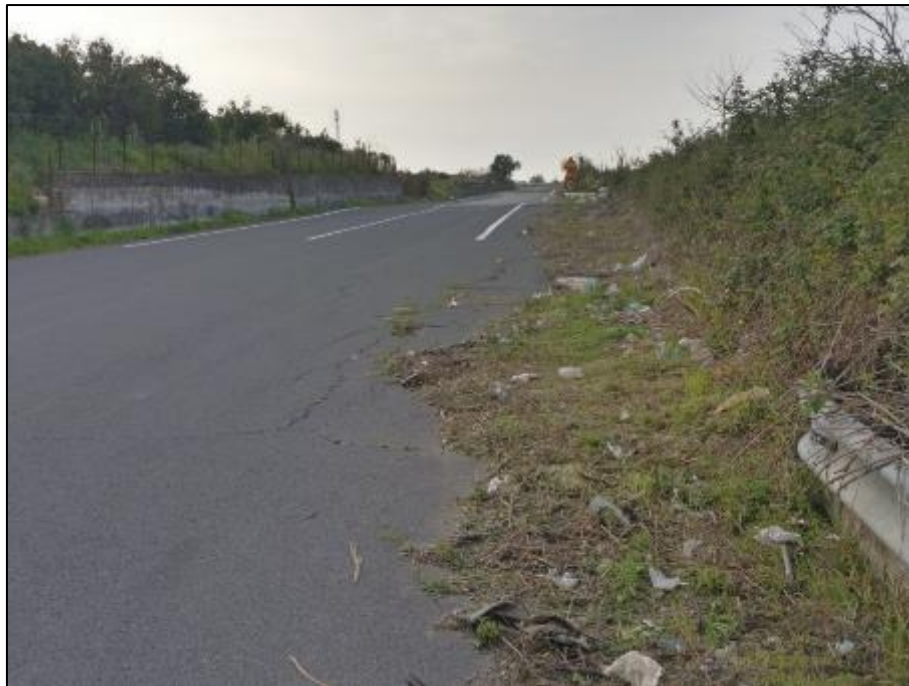
Foto 7.5 – Vistose lesioni e deformazioni presenti sulla strada di Svincolo citata coincidenti con il coronamento della Frana L4_1.
