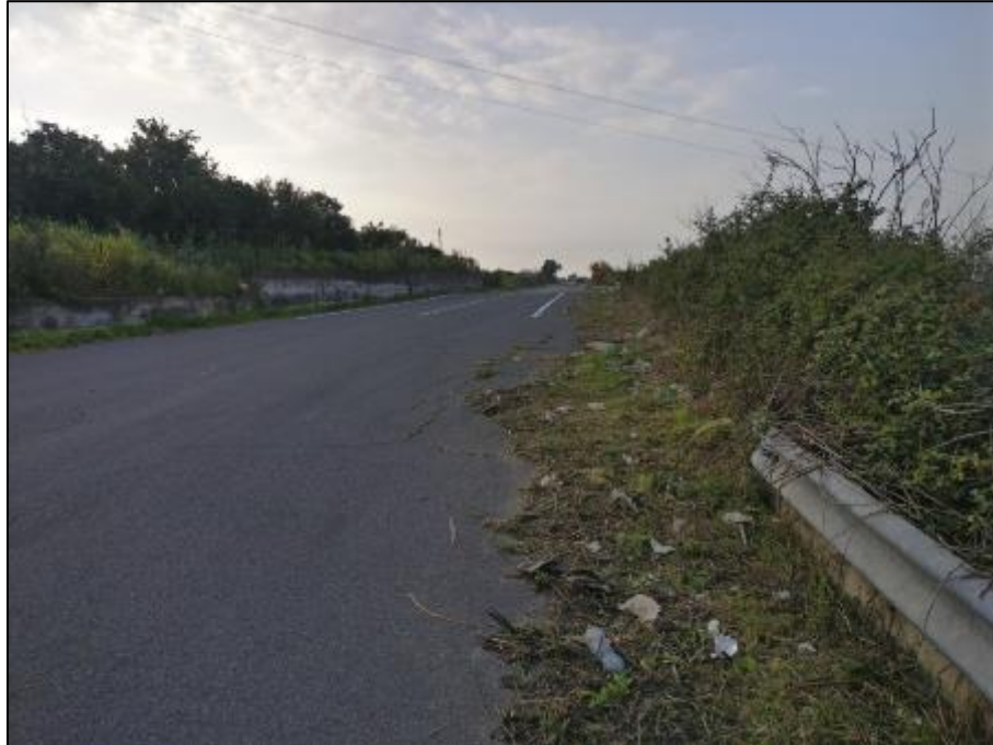
Foto 7.3 – Vistose lesioni e deformazioni presenti sulla strada di Svincolo citata coincidenti con il coronamento della Frana L4_1.
