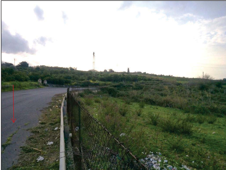
Foto 2.5 – Panoramica della zona di testata della Frana L4_1 testimoniata dalle diffuse lesioni presenti sul manto stradale.
