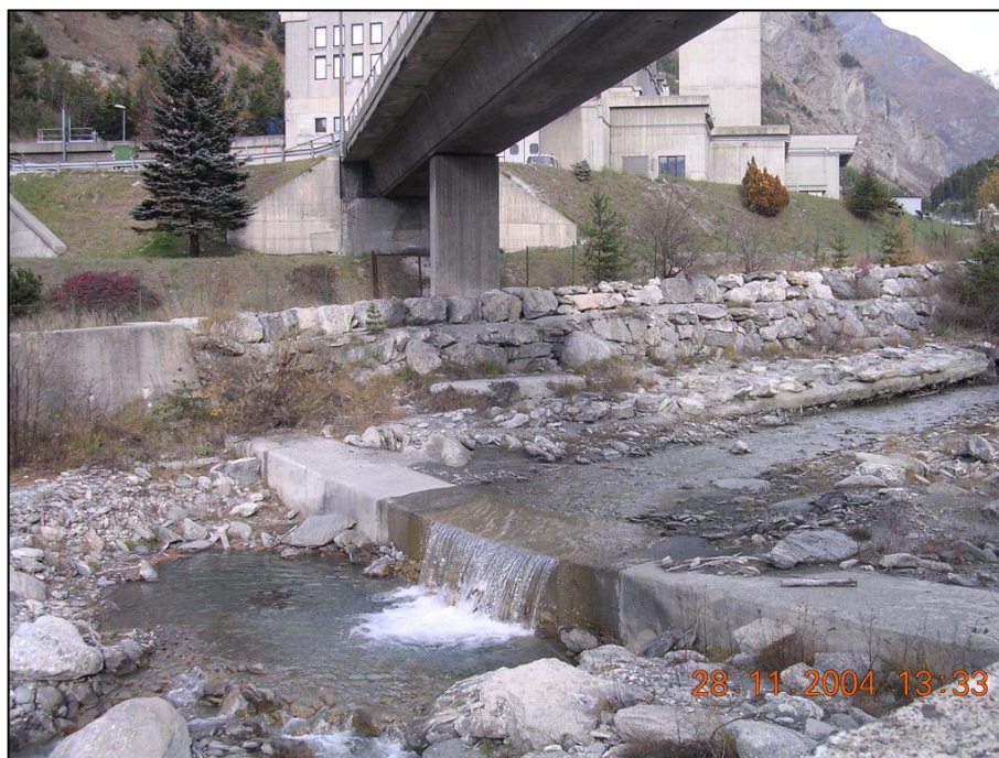
Briglia in calcestruzzo armato da riconvertire
