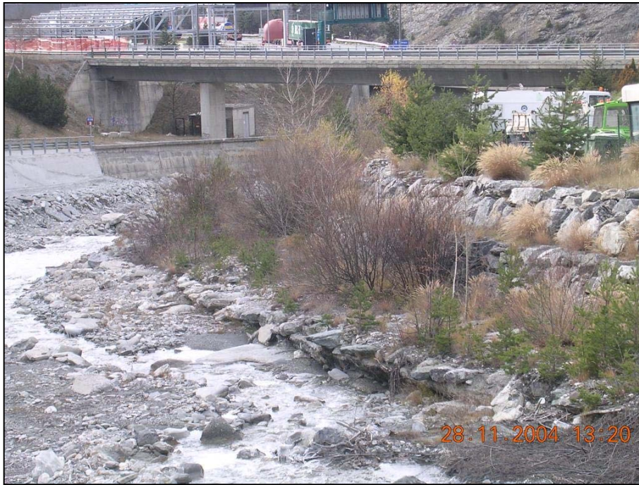
Platea di massi e calcestruzzo in parte erosa
