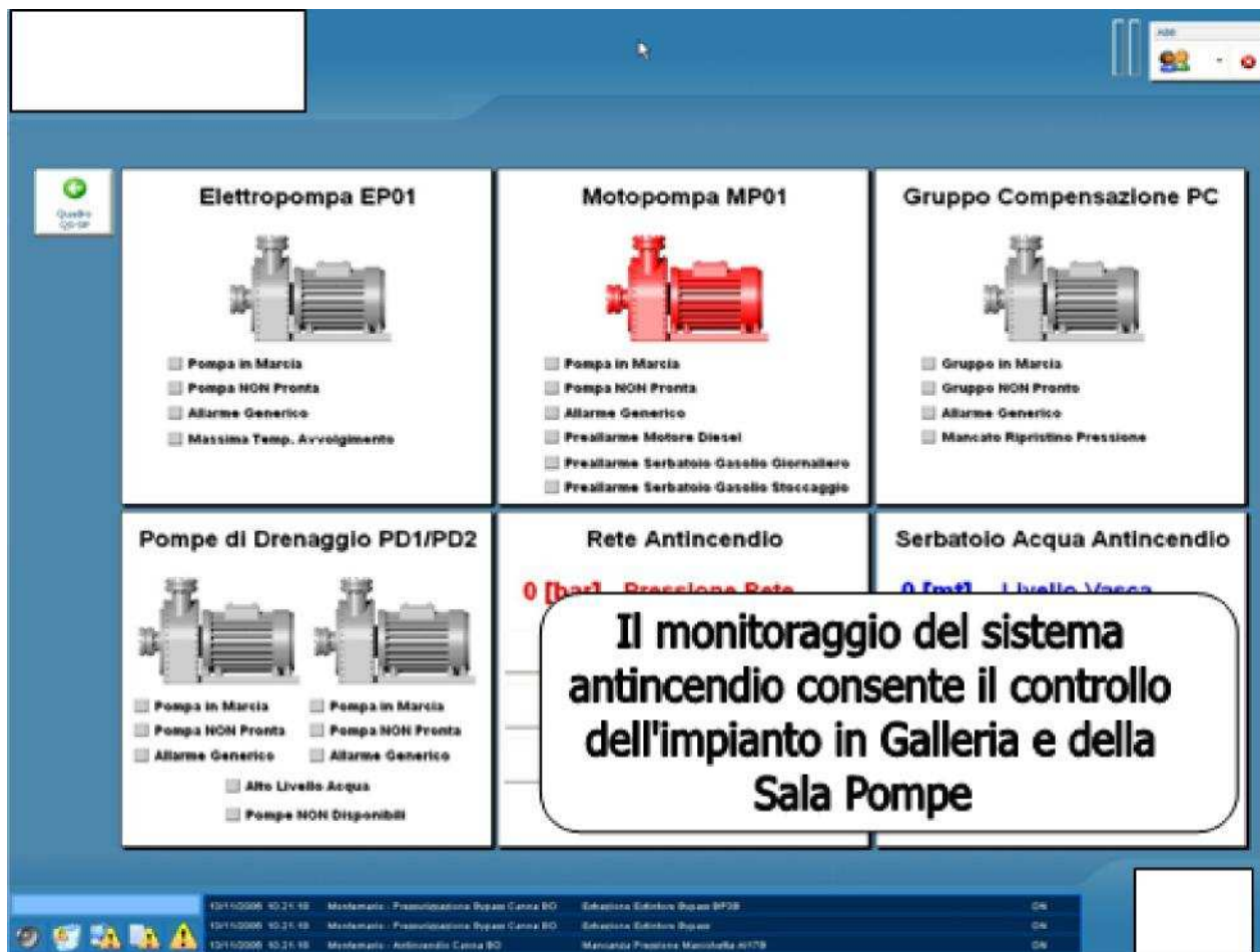
Fig. 8 – Sala pompe acqua antincendio – Su pagina separata viene rappresentato lo stato della rete idranti in galleria
