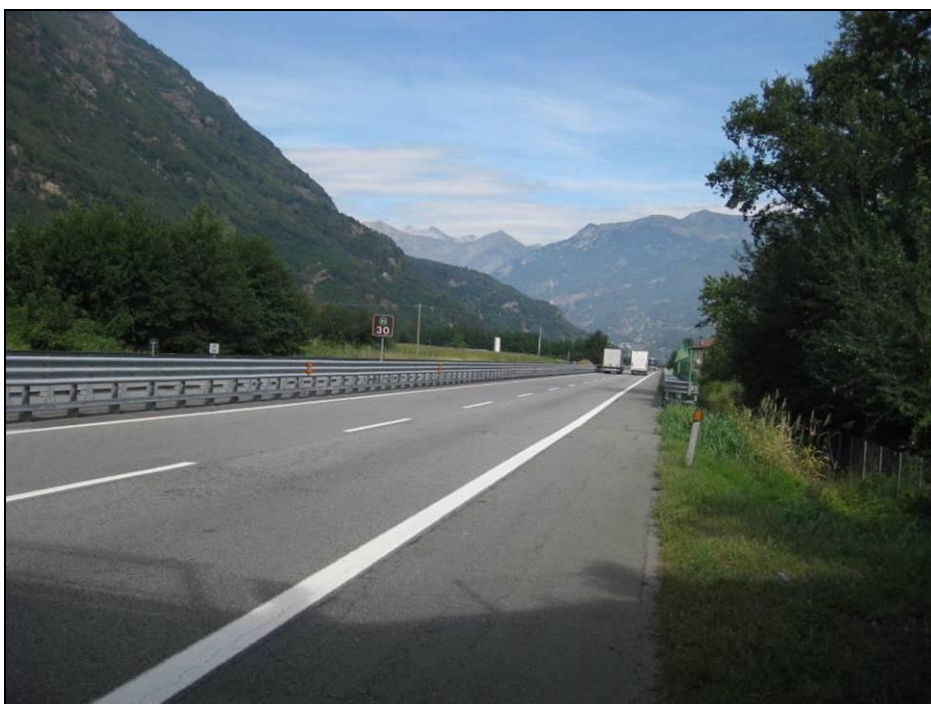
Figura 1.3/4 Autostrada A5 - Vista in direzione nord del punto di fine intervento, progressiva 45+650, in Comune di Borgofranco
