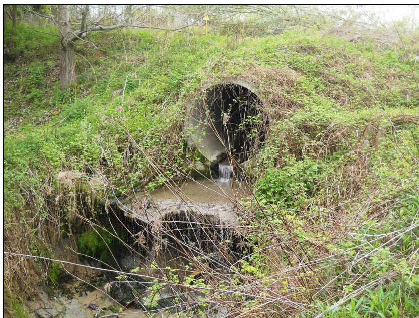
Figura 4.4/2 Scarico del Bioindustry Park a Colletero Giacosa, circa 2 Km monte dell'attraversamento della A5.
