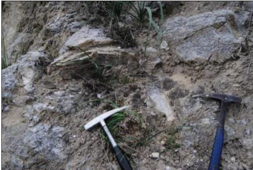
Foto 6.13 – Gessi cristallini rilevati presso lo Svincolo di Grammichele.
