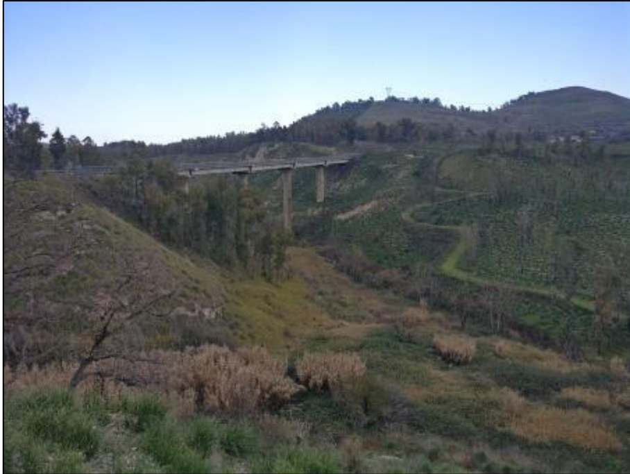
Foto 2-2 - Dissesto gravitativo di ridotte dimensioni areali (Frana L3_1), ubicato in prossimità del Viadotto Piano delle Rose.
