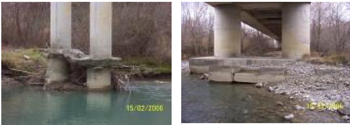
Figura 6.6 - esempi del fenomeno di erosione localizzata alla base delle pile.
