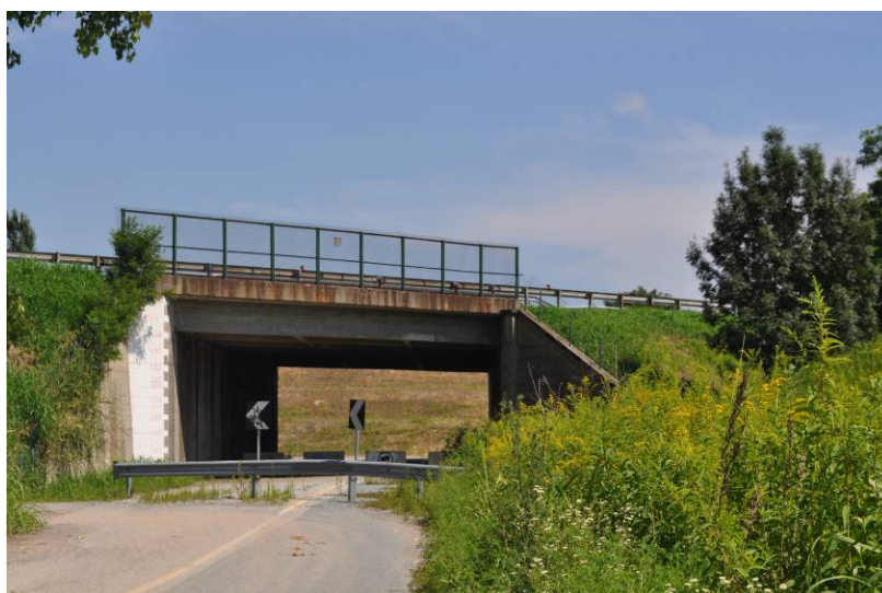
Foto 20 – km 41+200 , sottopasso in disuso (200m ca. a S del Viadotto Fiorano), lato O, da O
