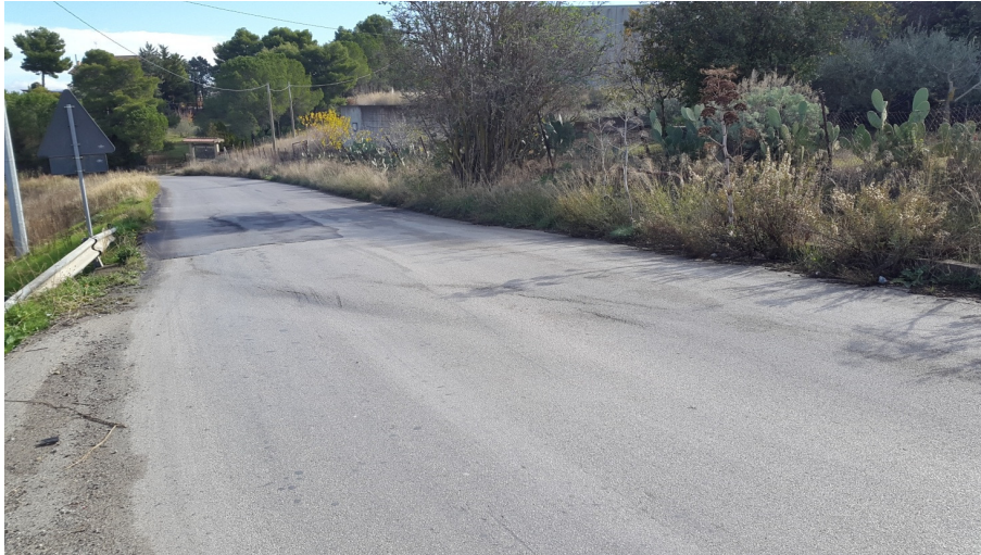
Figura 10 – Cedimenti della sezione stradale
