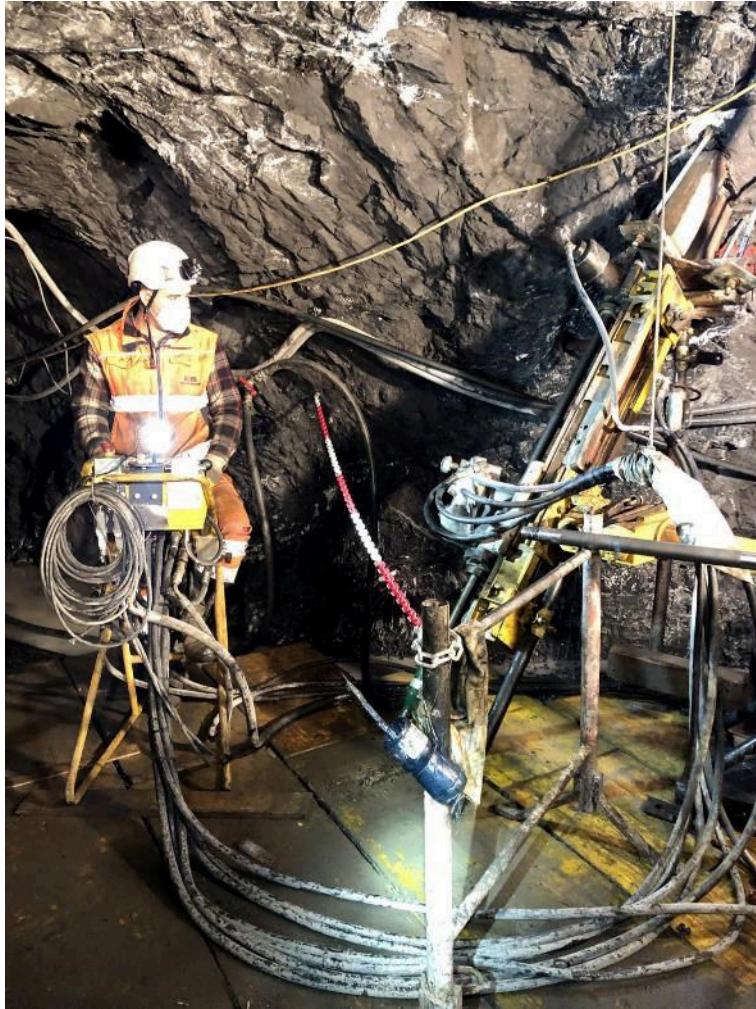
Foto 3: Sonda con operatore.
