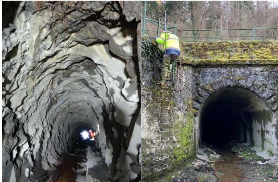
Figura 3-8: Galleria non rivestita con piano di calpestio laterale (sinistra) e sbocco della galleria con tratto rivestito e platea in bognini (destra). Ispezione del 09.03.2021.
