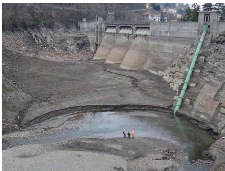
Figura 3-12: Situazione attuale con opera di presa dello scarico di fondo al di sotto del livello del sedimento, 09.03.2021
