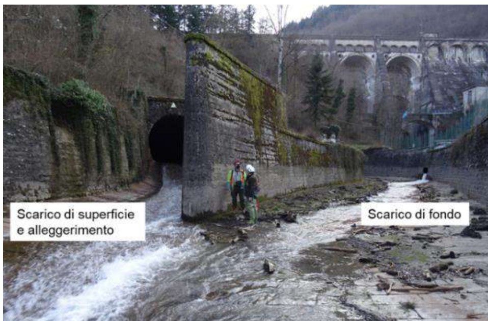
Figura 3-9: Confluenza della galleria dello scarico di superficie e di alleggerimento e dello scarico di fondo. Ispezione del 09.03.2021.
