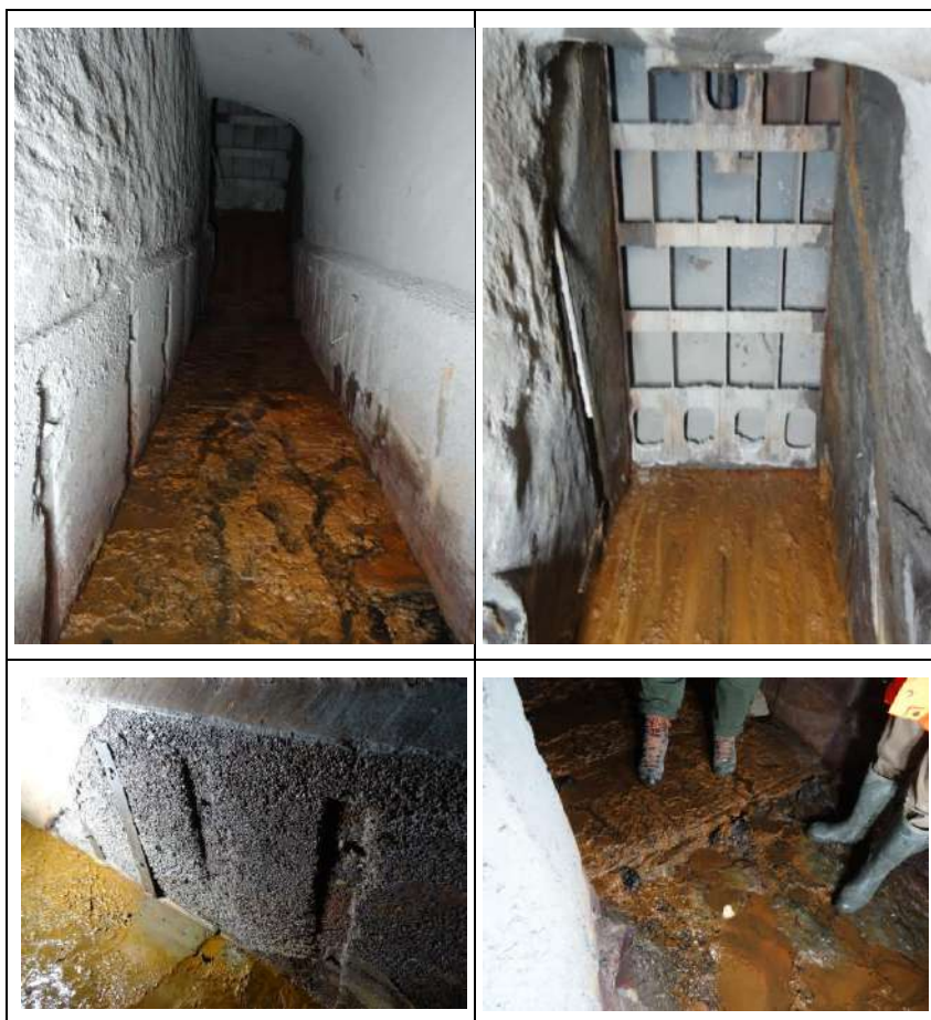
Figura 3-13: Cunicoli nel segmento di galleria a valle delle paratoie, con evidenza dei danni alle blindature (sopralluogo del 09.03.2021).
