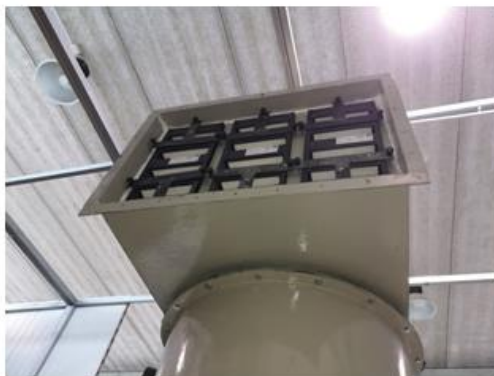
Figura 5b: Particolare filtri H13.
