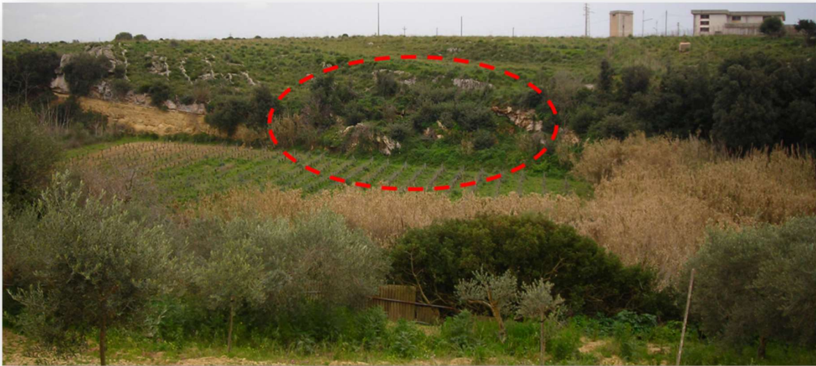
Fig. 4.9 – Versante in sinistra idrografica del Fiume Sossio: evidenziato in rosso, presenza di detrito di frana, con un blocchi calcarenitici immersi in matrice prevalentemente sabbiosa. Immediatamente a tergo di tale detrito, l'ammasso si presenta detensionato, con una morfologia a gradini.
