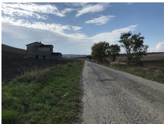
30 - Località Santo Spirito, tratto di elettrodotto diretto a SW, visto da NE.
