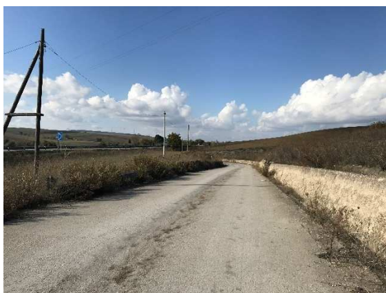
32 - Fiume Basentello, tratto di elettrodotto diretto a WNW, visto da ESE.
