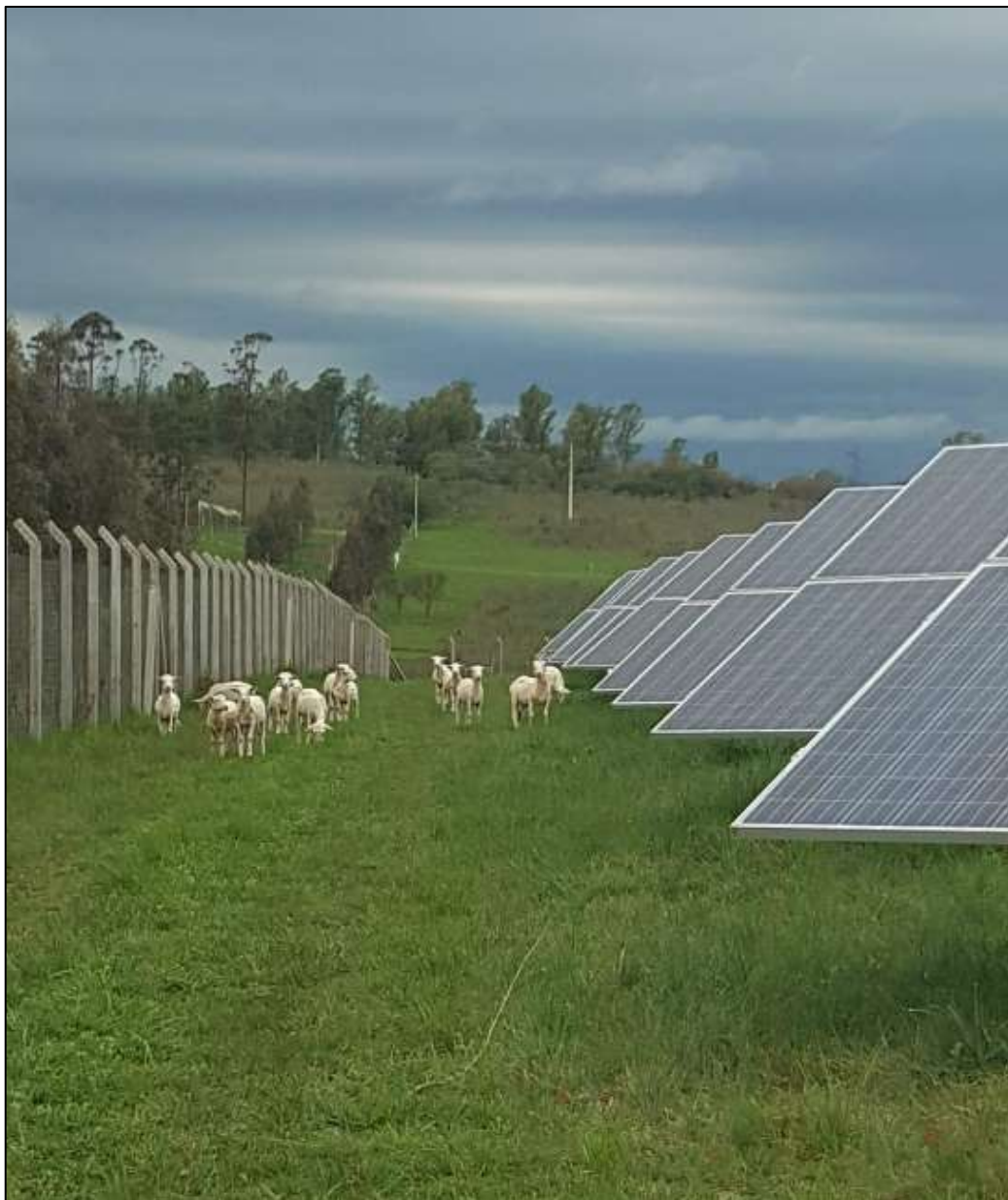
Pecore al pascolo all'interno di un impianto fotovoltaico
