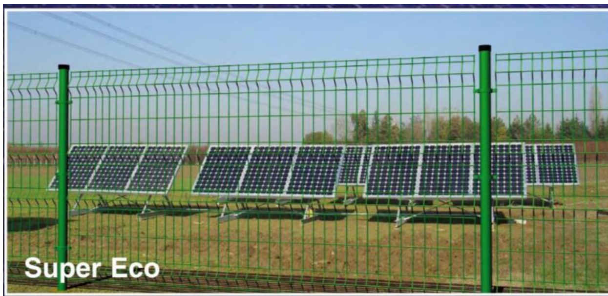
Fig.: Tipico della recinzione perimetrale (in quella installata sarà sempre lasciata una luce libera di 10 cm da terra)
