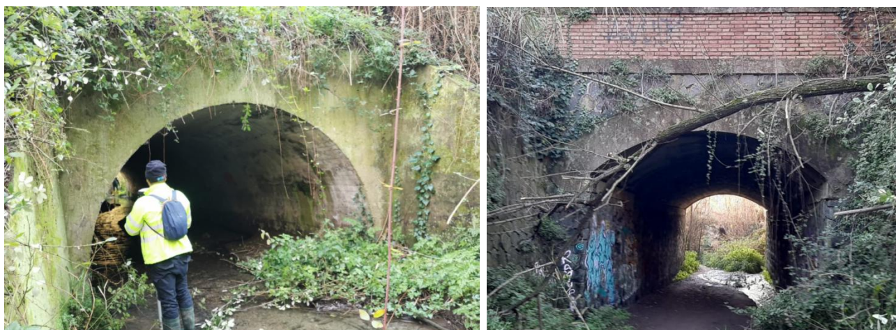
Figura 6 – Foto dei manufatti idraulici esistenti alle progr. 1+370 (a sinistra) e 1+434 (a destra).
