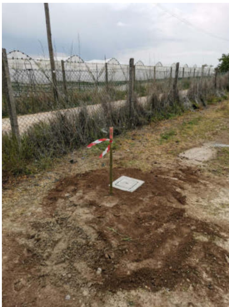
Figura 6 – Chiusino carrabile a protezione della strumentazione installata nel sondaggio S44_PZ.
