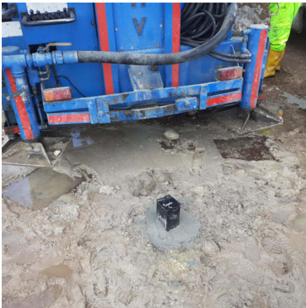
Figura 10 – Chiusino in Ferro a protezione della strumentazione installata nel sondaggio S03.
