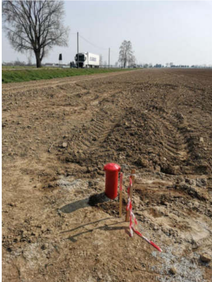
Figura 6 – Chiusino in PVC a protezione della strumentazione installata nel sondaggio S33_PZ.
