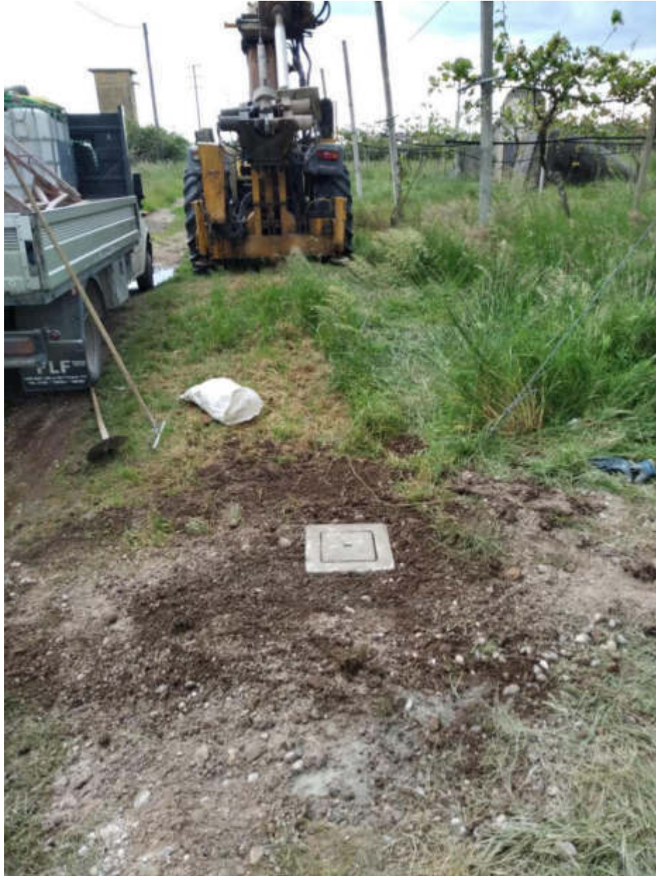
Figura 9 – Chiusino in cemento prefabbricato a protezione della strumentazione installata nel sondaggio S01.
