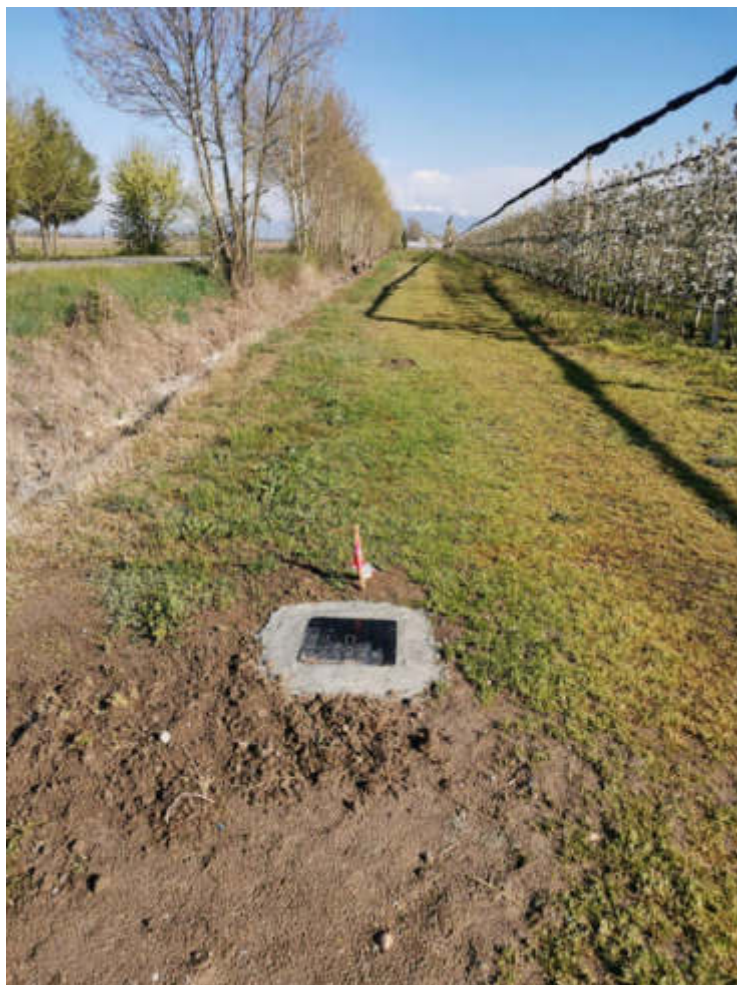
Figura 11 – Chiusino carrabile a protezione della strumentazione installata nel sondaggio S37_PZ.
