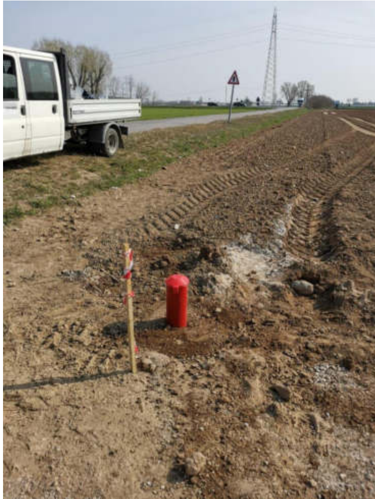
Figura 6 – Chiusino in PVC a protezione della strumentazione installata nel sondaggio S32_PZ.
