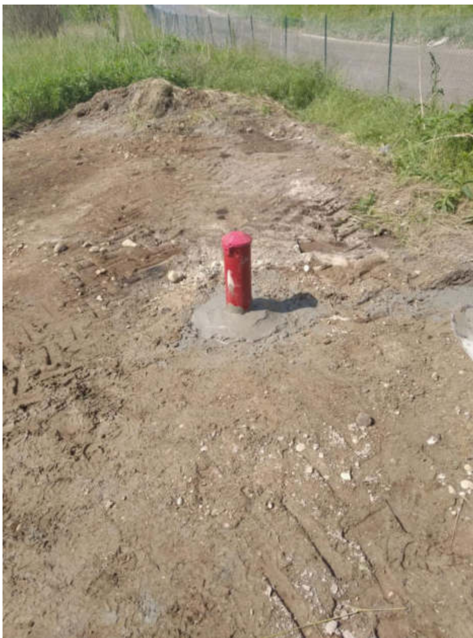
Figura 10 – Chiusino in PVC a protezione della strumentazione installata nel sondaggio S03.
