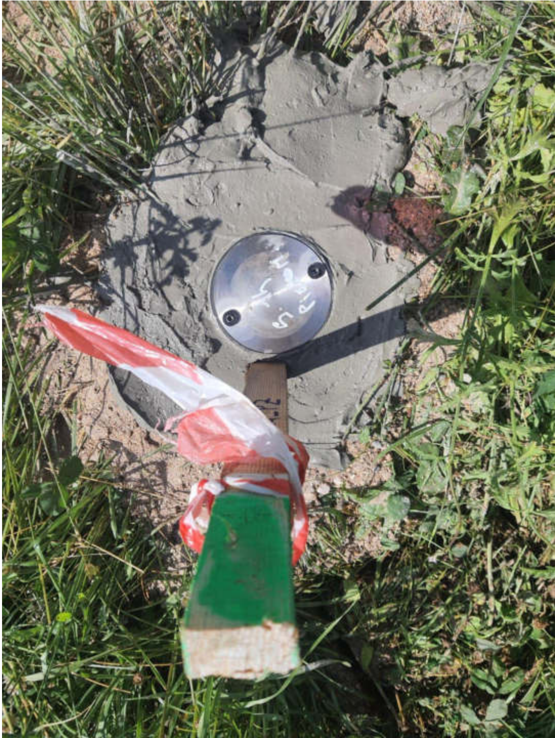
Figura 7 – Chiusino in ferro prefabbricato a protezione della strumentazione installata nel sondaggio S14_PZ
