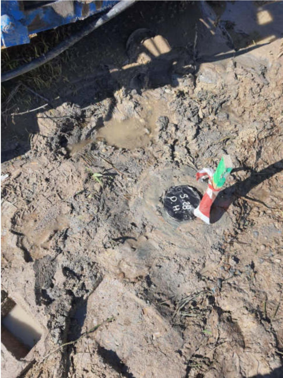
Figura 11 – Chiusino in ferro prefabbricato a protezione della strumentazione installata nel sondaggio S28.
