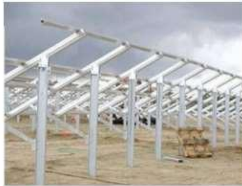
FIGURA 18 - STRUTTURE DI SOSTEGNO (TRACKER)
