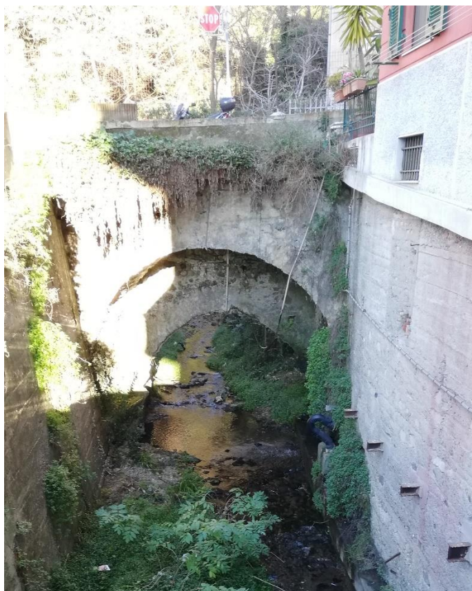
Figura 18 – Attraversamento di via Caldesi – Pontino ad arco con doppio abbassamento dell'intradosso - SEZ.8/9
