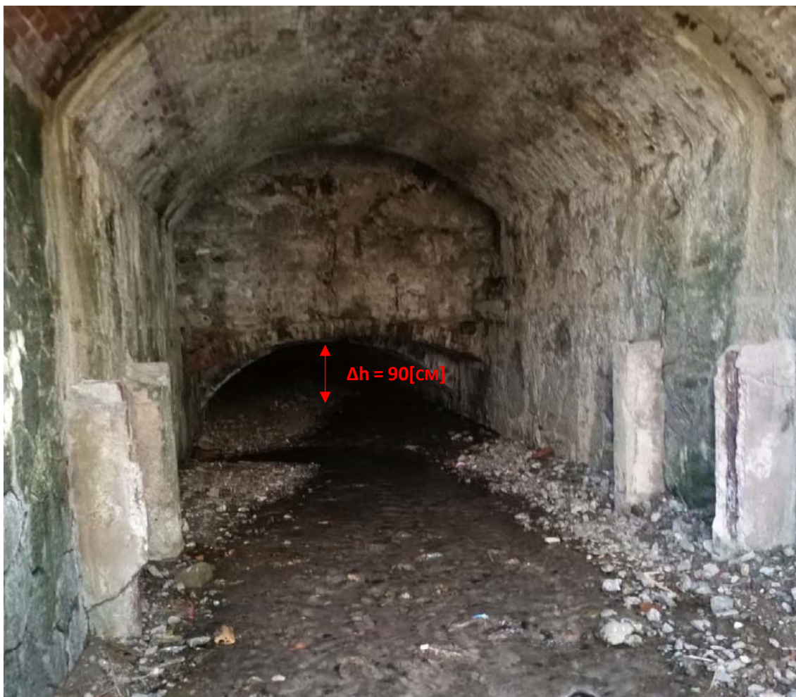
Figura 22 – Significativo ribassamento dell'intradosso della copertura – SEZ.22 ÷ SEZ.24
