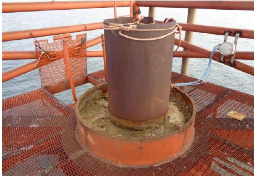
Figura 3 – Struttura monopalo a quota +12.8 m s.l.m.”
