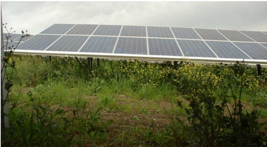
Figura 16: Caso studio Parco Fotovoltaico "Villalba di Gesù" da 5 MW (Foto G.Filiberto)
