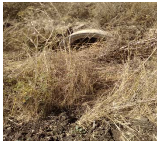
Figura 12 - Tombini idraulici di attraversamento, ubicati in corrispondenza delle intersezioni con la viabilità interna, parzialmente occlusi
