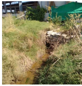
Figura 13 - Acque di scarico provenienti dalla Masseria, che dovranno essere considerate come contributo aggiuntivo nelle verifiche dei fossi
