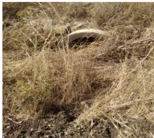
Figura 3-2 – Tombini idraulici di attraversamento, ubicati in corrispondenza delle intersezioni con la viabilità interna, parzialmente occlusi
