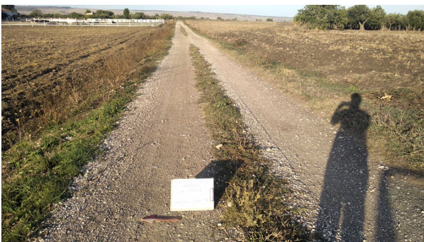
Foto 41 Cavidotto su strada sterrata
