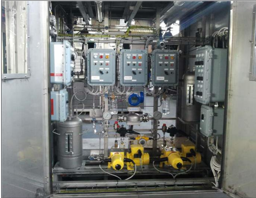
Figura 35 - Sistema di Odorizzazione
