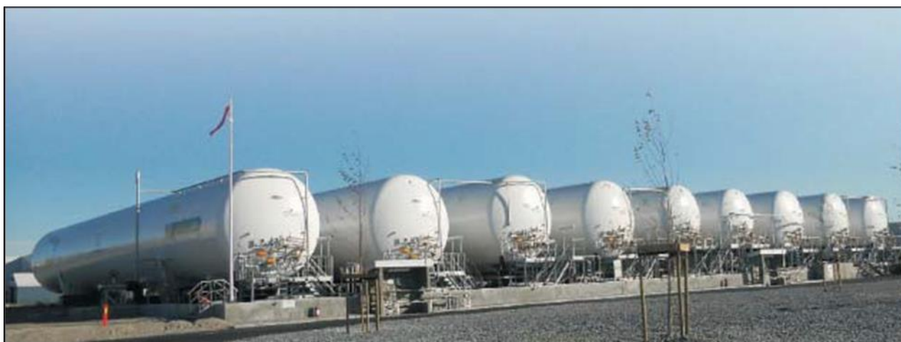
Figura 24 - Esempio di serbatoi criogenici (impianto GNL a Fredrikstad – Norvegia)
