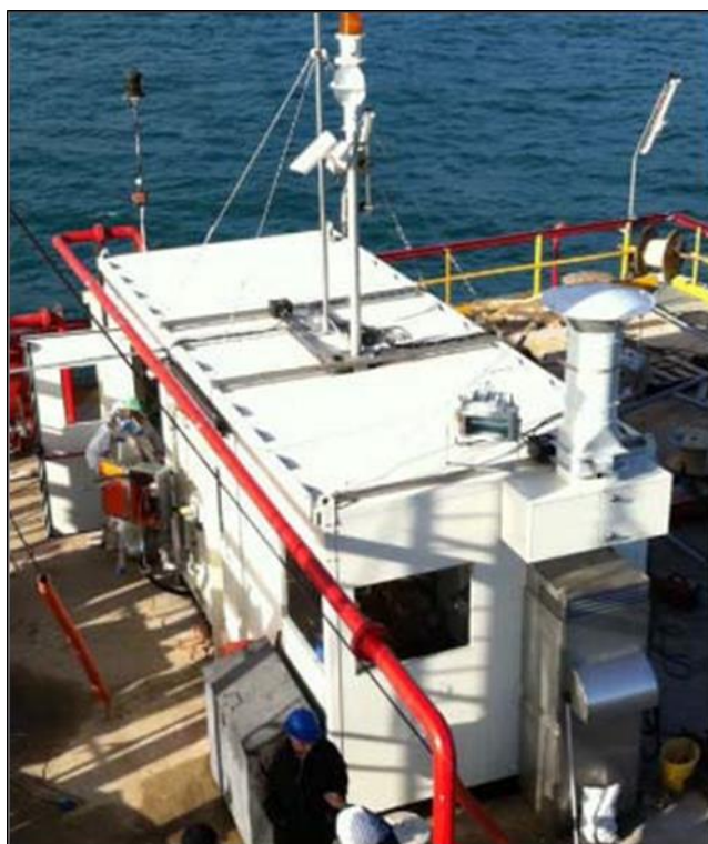
Figura 16 - Esempio Control room
