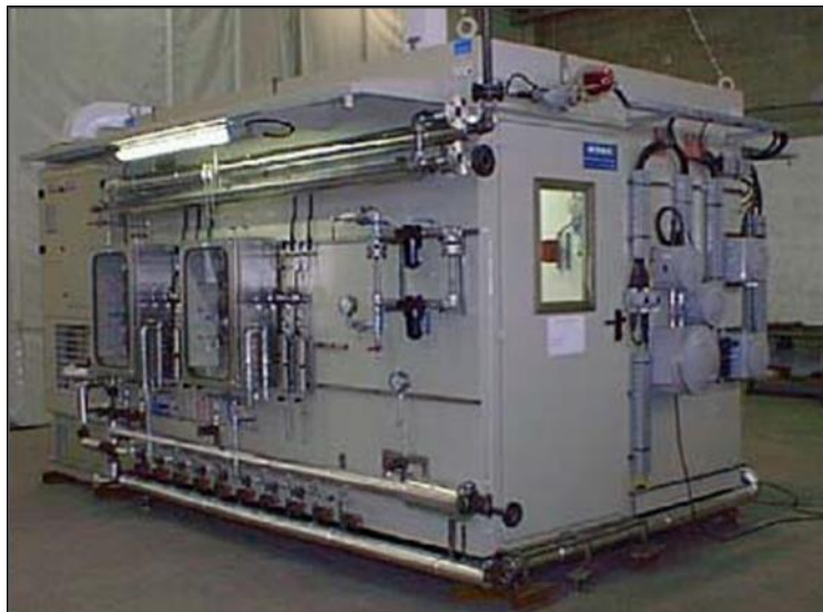
Figura 34 - Skid Sistema di analisi – Cabina cromatografi
