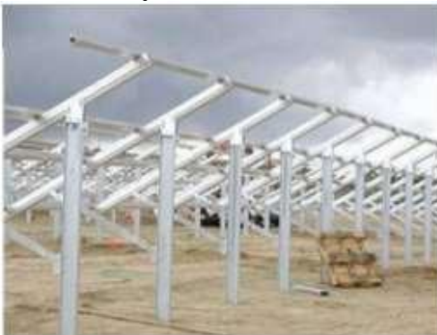
FIGURA 3 - STRUTTURE DI SOSTEGNO (TRACKER)
