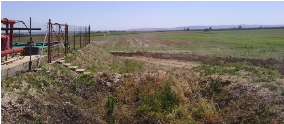
Figura 13: Vasca attualmente presente in sito, lato sud con scale e basamento in c.a.
