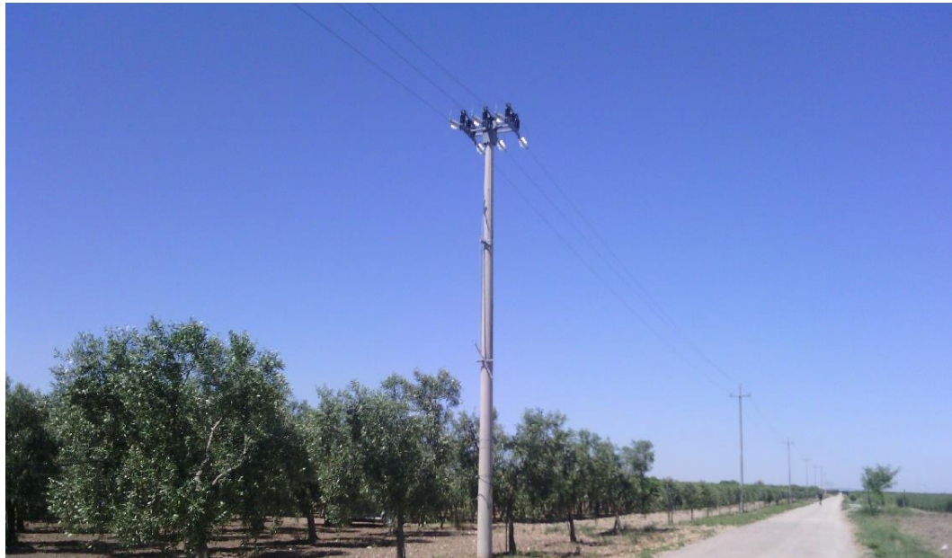
Figura 22: Pali elettrici MT - vista lungo viabilità asfaltata, lato nord dell'area d'impianto, in direzione ovest
