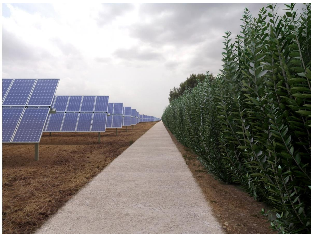
Figura 37 - - PV 11 Punto di vista interno all'area di impianto in progetto: particolare area interna, pannelli, strutture tracker, interventi di mitigazione con vegetazione autoctona
