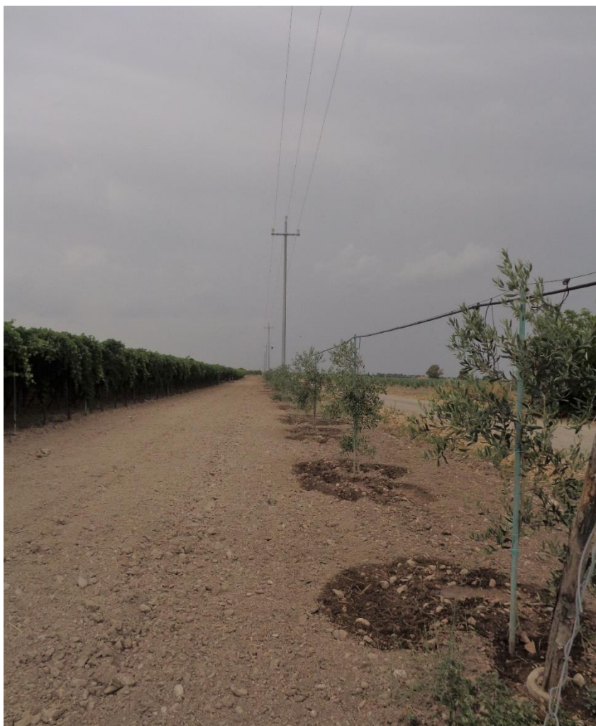
Figura 8 – Linea MT presente in sito sul lato Nord
