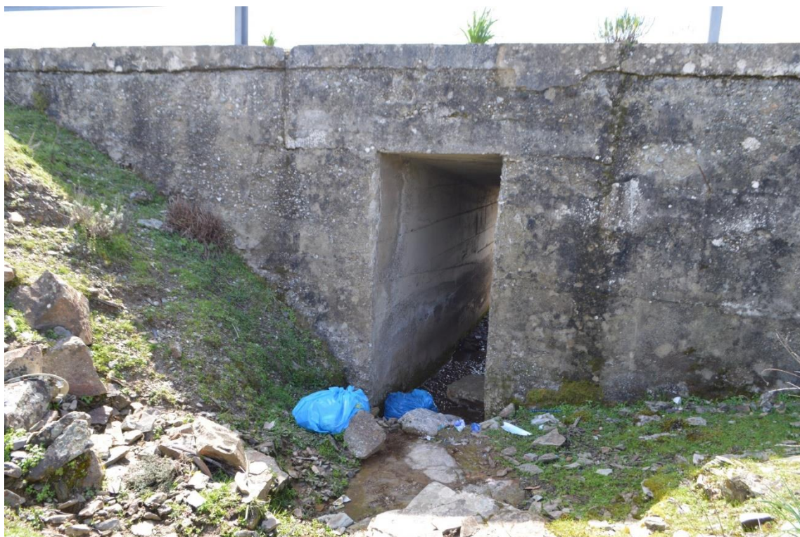
Figura 15 - Sottopasso per il deflusso delle acque meteoriche al di sotto della S.P.13, lato nord
