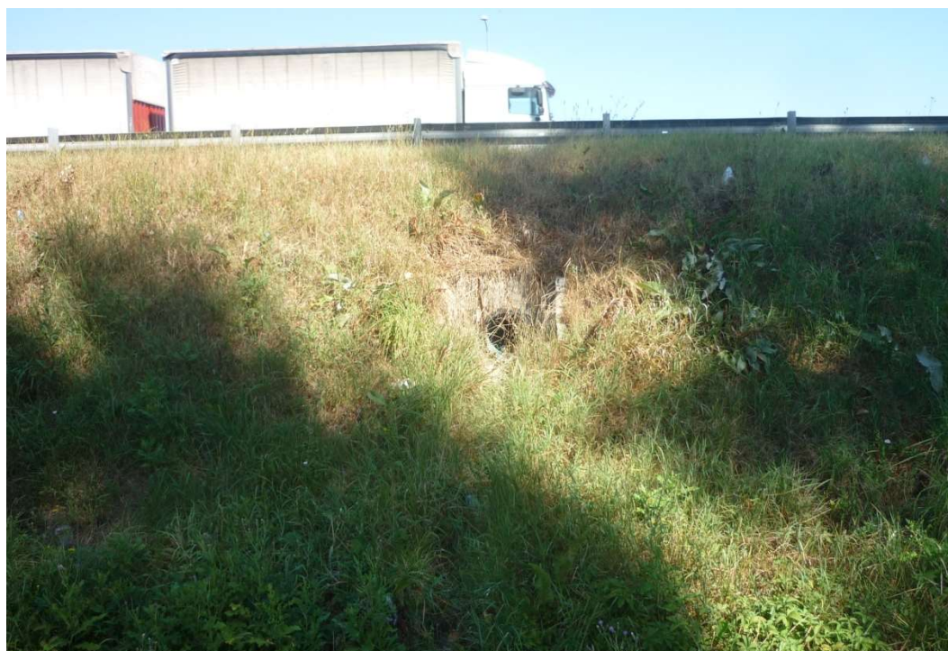
Figura 4-9: Esempio di manufatto di sbocco tubazione trasversale di convogliamento acque di piattaforma A14.
