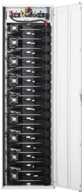
Figura 5 Esempio rack batterie
