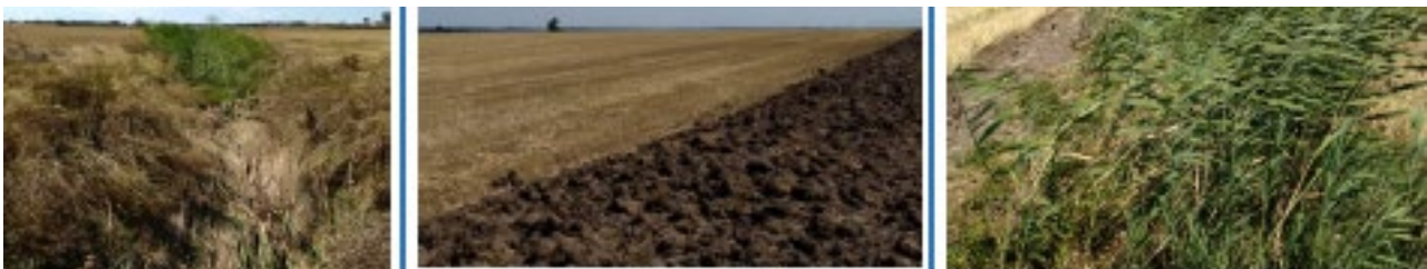
Figura 19 - Foto da sopralluogo rappresentanti le aree di intervento e lo stato dei fossi esistenti
