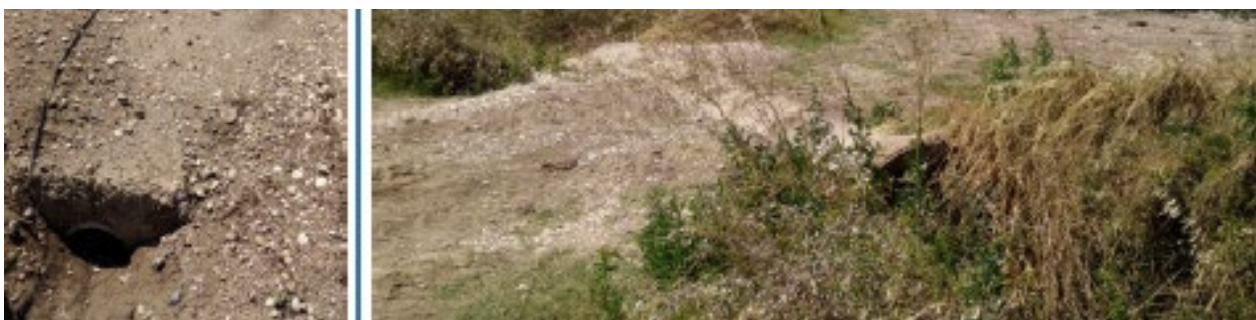
Figura 20 - Tombino ostruito da fenomeni di interrimento e tombino in corrispondenza di accesso ad una proprietà
