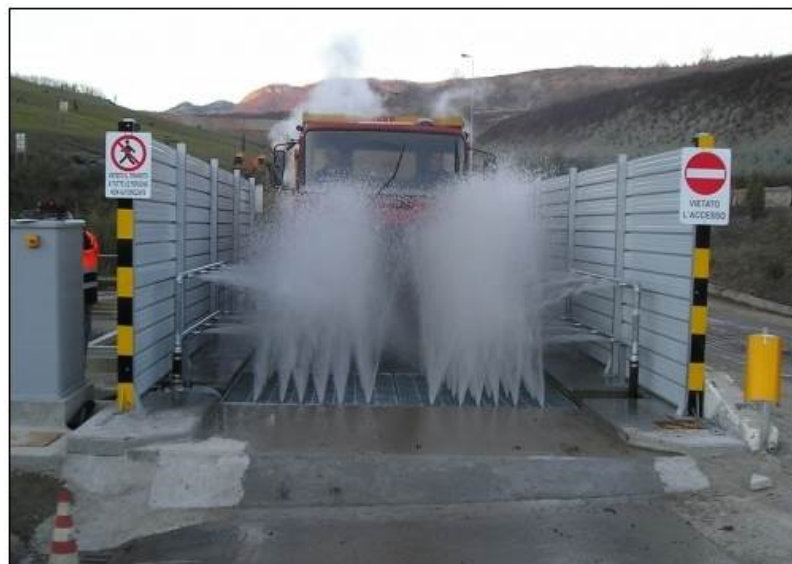
Impianto lavaggio ruote
